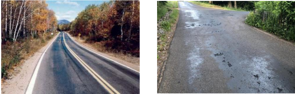
Figure .I .25 : Ressuage sur emploi partiels à l'émulsion
