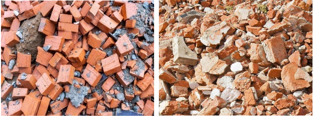
Figure II.8 : Débris de briques et de béton sur un chantier après la démolition.
