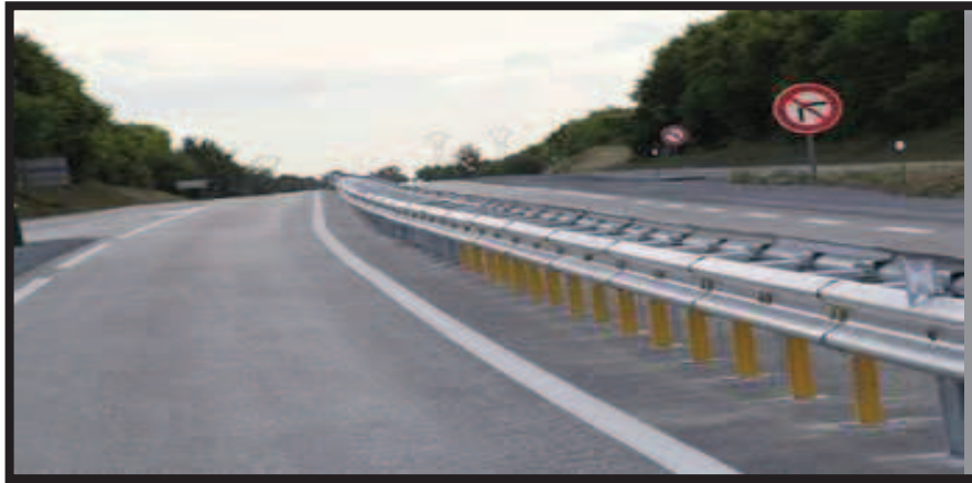
Figure XI.12 : photo d'une glissière de sécurité
