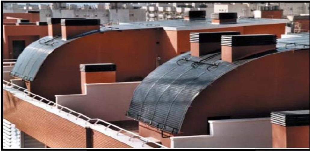
Figure II.2 : Installation de production d'eau chaude sanitaire [22].
