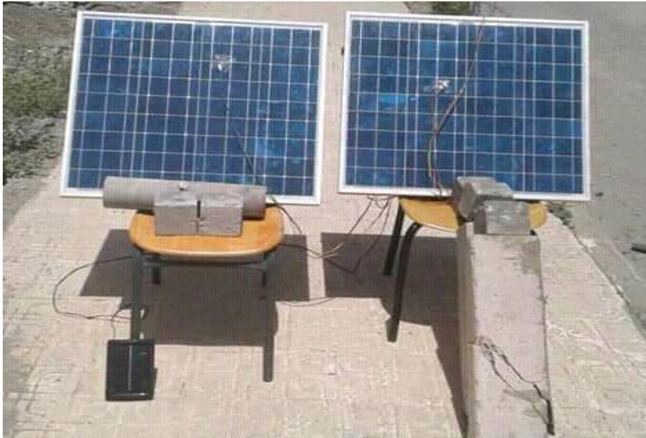
Figure V.1 : Les deux panneaux photovoltaïques utilisés.
