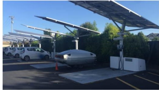
Figure 98 : Panneaux solaires des parkings Source : http://www.youtube.com/watch?v=TITTVGiUU5U
