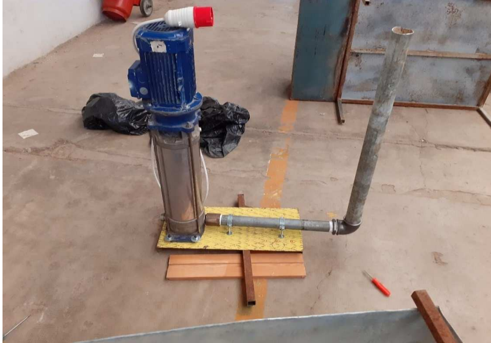
Figure.4.3. La pompe et les conduites utilisées.
