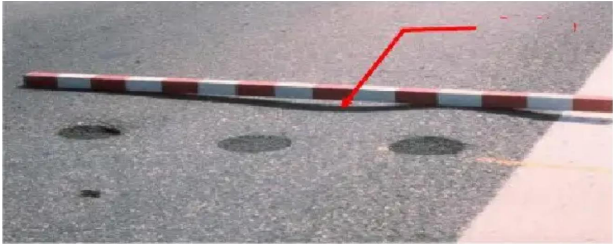
Figure I.14. Orniérage à faible rayon (Zemmiri, 2008)
