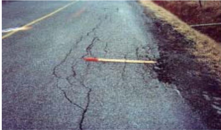
Figure I.15. Affaissement de rive (MTQ, 2002)
