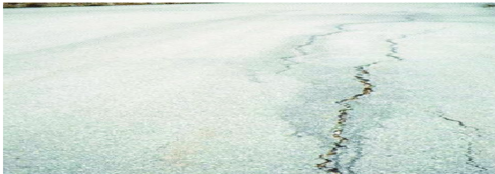
Figure I.18. Fissures longitudinales (Beghin, 2003)
