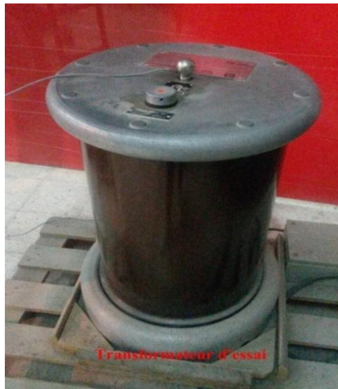
Fig.II.2 : Photographie du transformateur d'essai.
