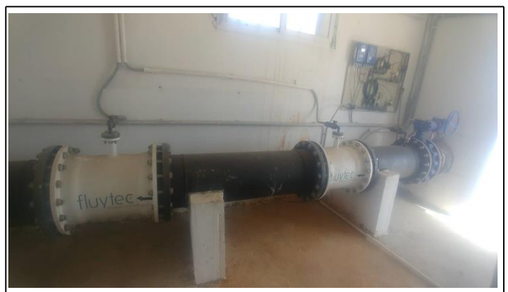
Figure IV.4 : Chambre de vannes
