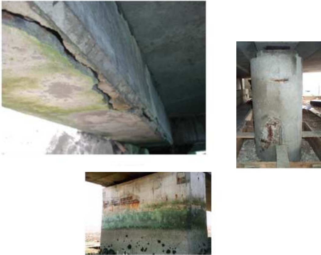
Figure 2.10: Quelques photos d'ouvrage en BA dégradés par l'eau de mer [39].
