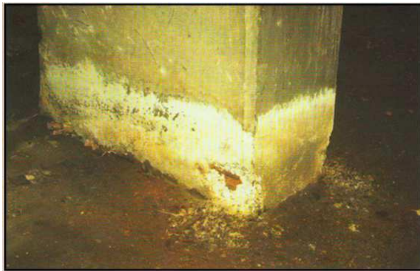
Figure 2.4 : Dégradation du béton par réaction sulfatique en pied de poteau [30].
