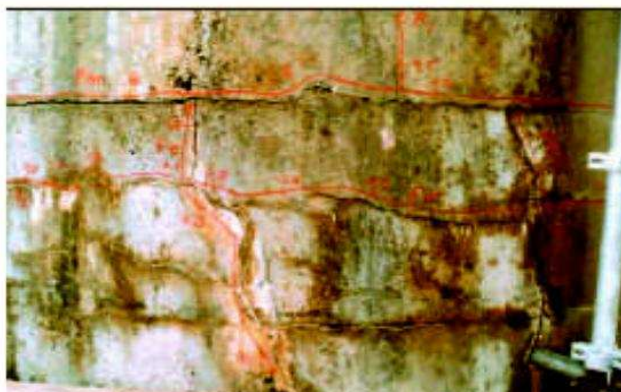
Figure 2.8 : Pile de pont affectée par une réaction de gonflement interne due à la formation d'ettringite différée.
