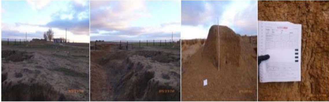
Fig. VI-12 étude géologique du PK18+640- PK18+700 PK16+000. Oued traversé par le tracé qui se dirige vers F'kirina
