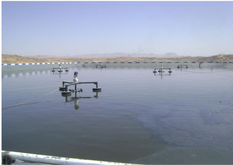
Figure I.2 : bassin d'aération de la STEP.
