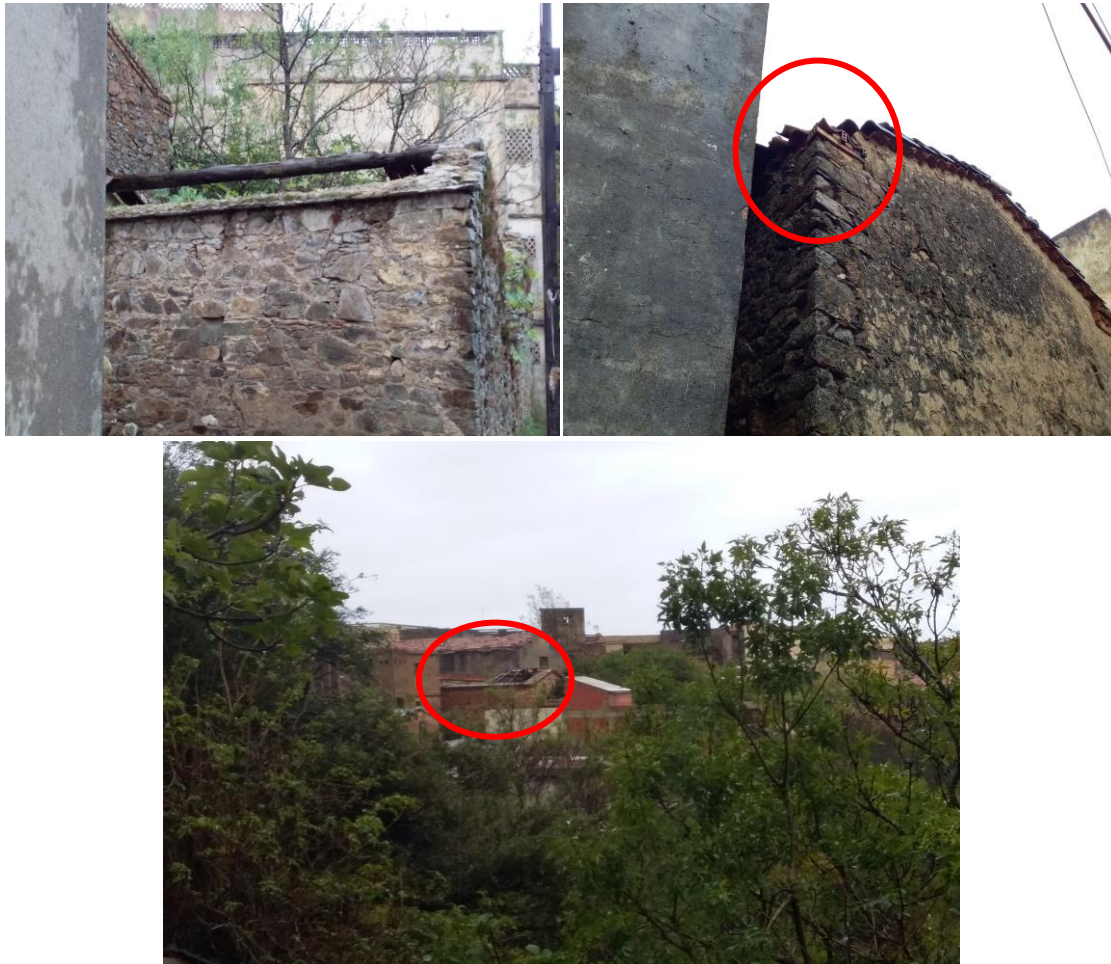
Fig.34 -Les dégâts causés par le magot au niveau des toitures des maisons
