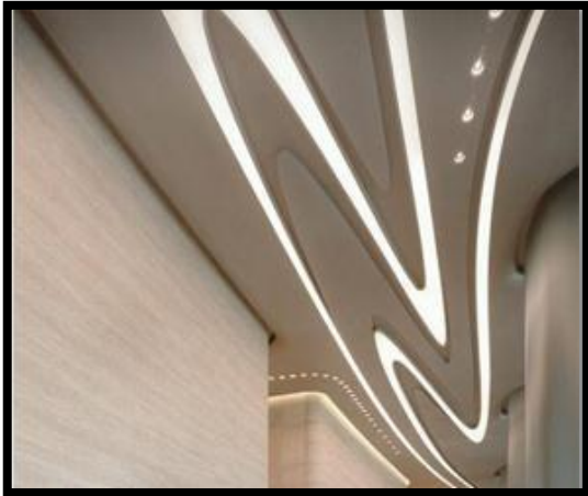
Figure 72 : faux plafond en plâtre www.placo.ltech-alu.com
