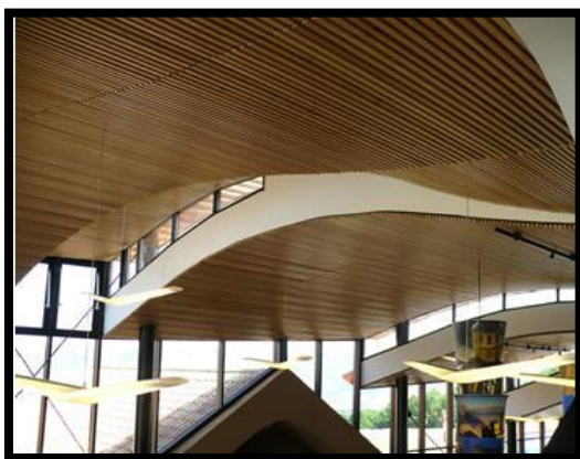
Figure 75 : Faux plafond en bois www.belet-isolation.com
