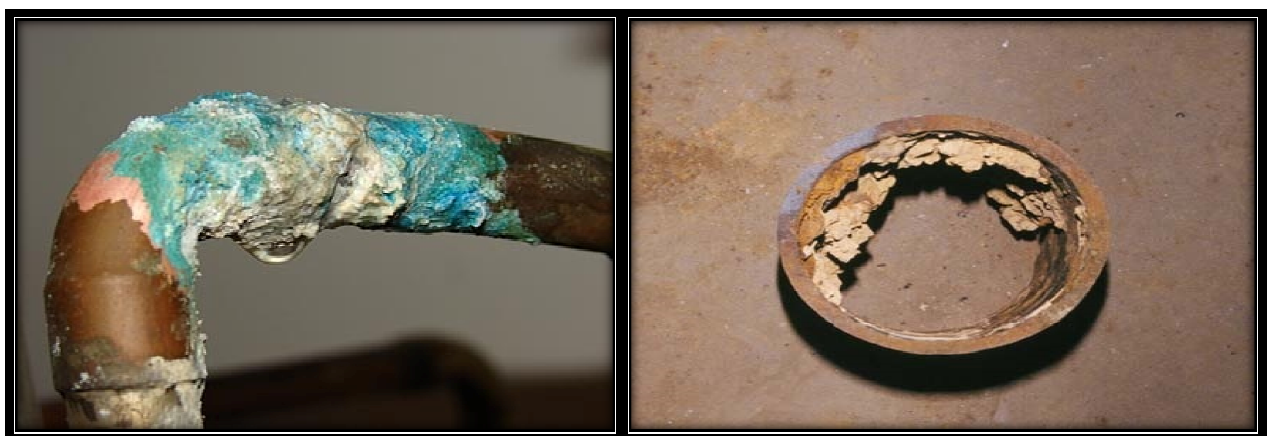
Figure 5.14 : la corrosion dans les conduites
