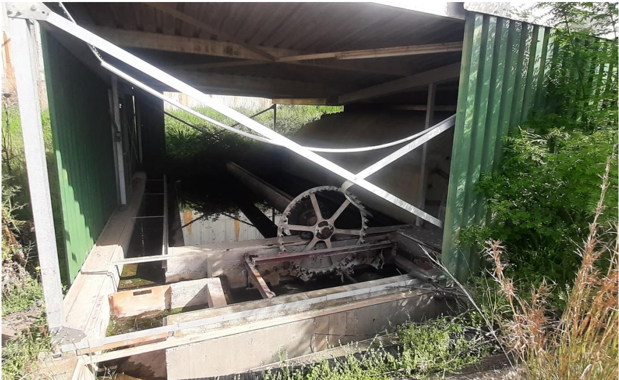
Figure 6 : Station d'épuration de l'Electro-Industries d'AZAZGA (Originelle, 2022).
