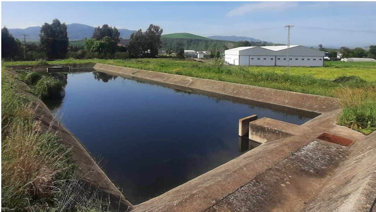
Figure 9 : Eau du rejet industriel final de la station d'épuration (Originale, 2022).
