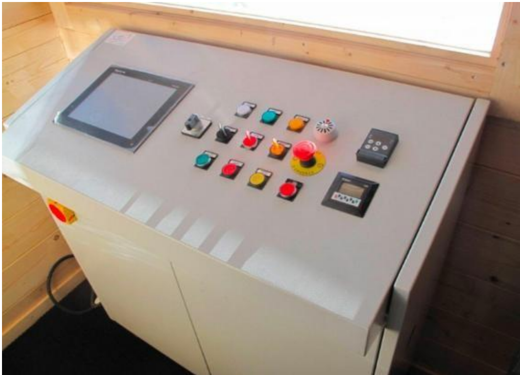
Figure II.8 : La façade du pupitre de commande d'une armoire électrique.
