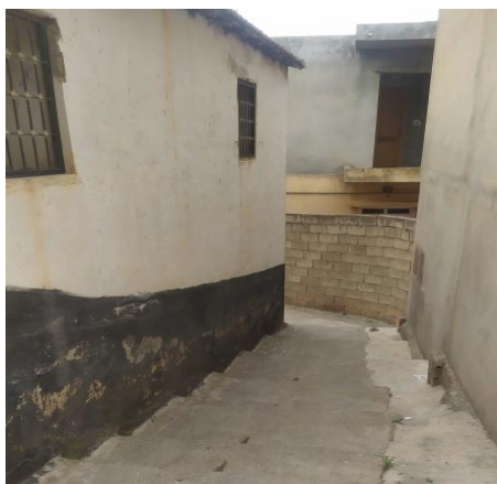
Figure 138: impasse au village Ait Amar. Source : les auteurs 11/12/22.
