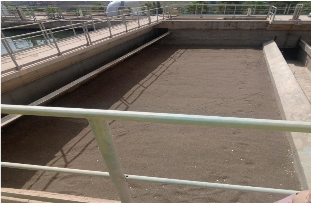
Figure n°6 : Filtre à sable ouvert.
