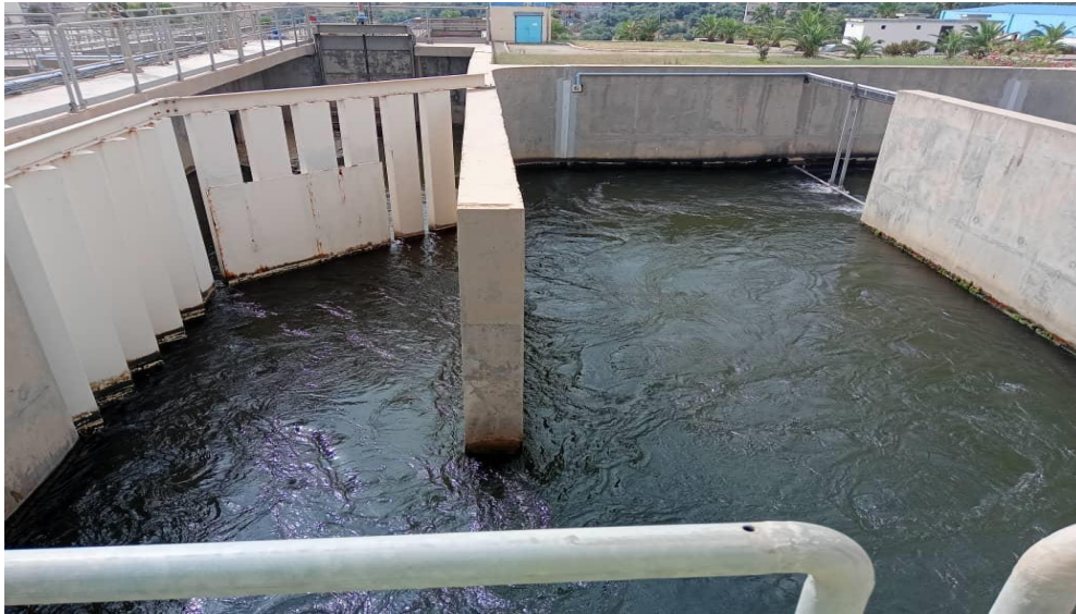
Figure n°4 : Chambre de mélange.
