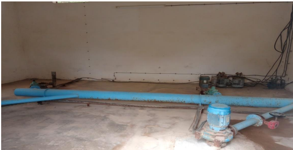
Figure n°9 : Les conduites qui sortent des puits de relevages.
