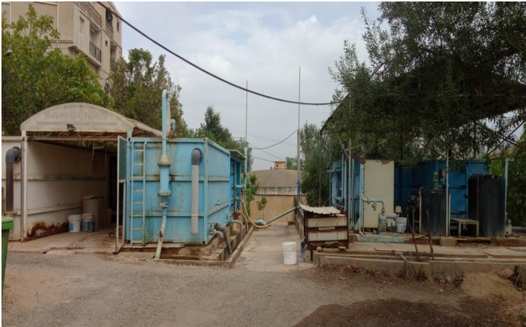
Figure n°7 : Les deux filières de traitement de la station monobloc IMSOUHAL.
