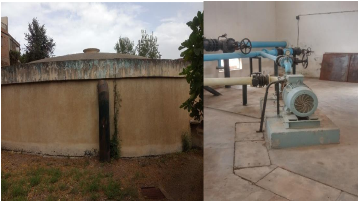
Figure n°12 : Réservoir de la station et la pompe de refoulement.
