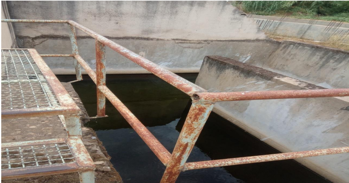
Figure n° 8: les bassins de décantations.
