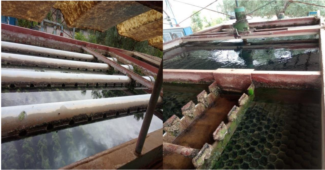
Figure n°10 : Les décanteurs ouverts des deux filières de traitement.
