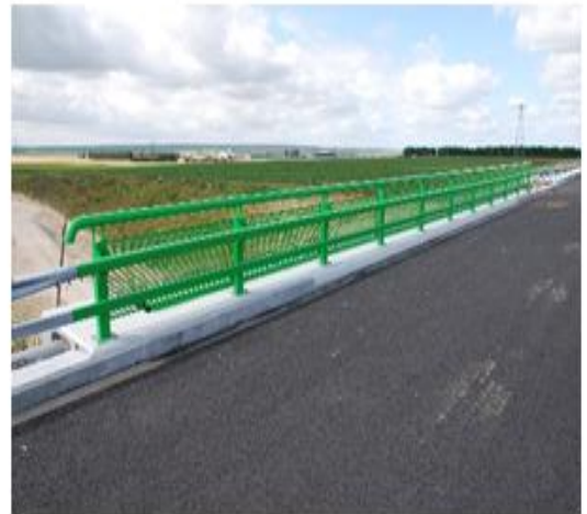
Figure 39 : Garde-corps et Barrières de Sécurité
