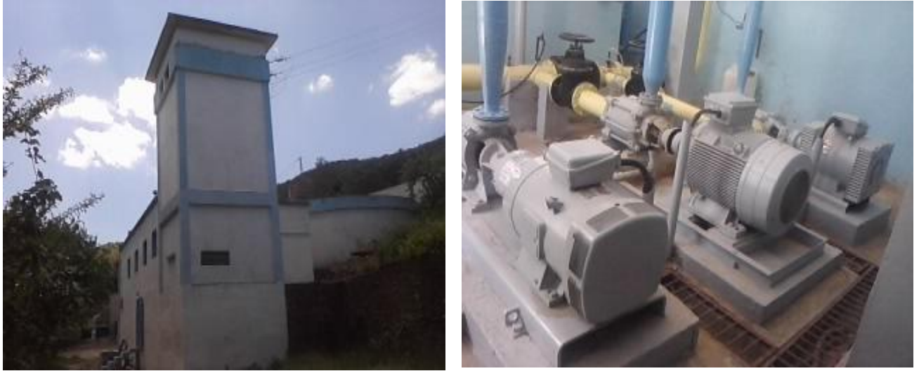
Figure III.8 Réservoir d'arrivée et station de refoulement ( station de reprise n°1)
