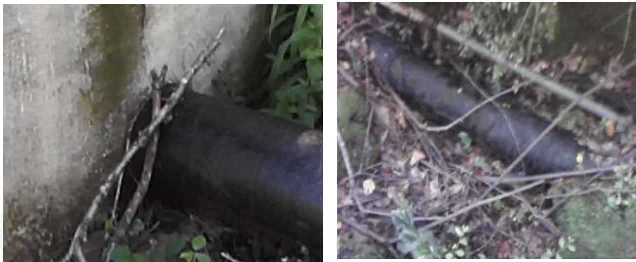
Figure III.7 Les conduites utilisées
