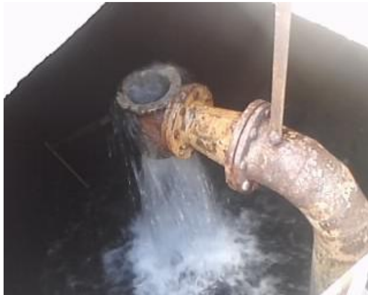
Figure III.9 L'arrivée de l'eau au réservoir de souueur
