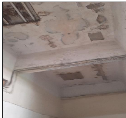
Figure 59: photo de l'état dégradé à l'intérieur du bâtiment de l'ancienne gare, source : auteurs
