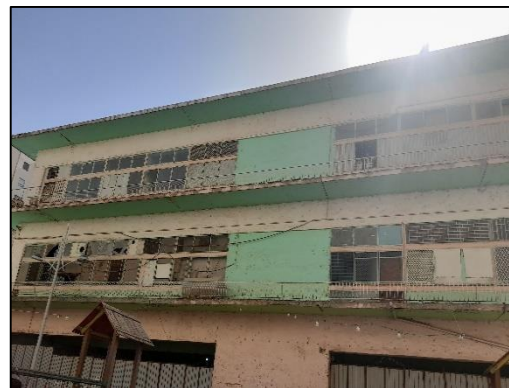
Figure 58: photo d'une façade dégradée du bâtiment de l'ancienne gare, source : auteurs
