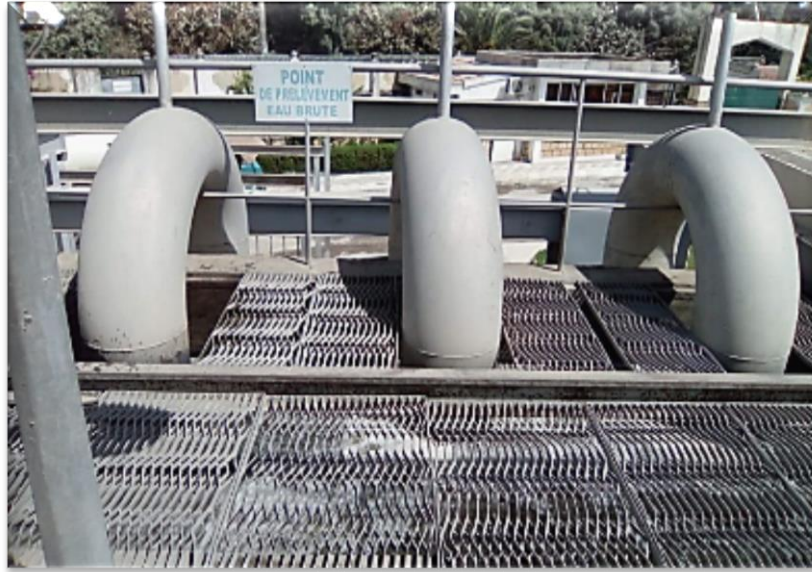
Figure 3 : poste de relevage.
