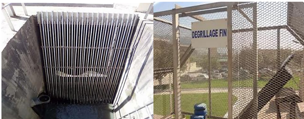
Figure 4 : Dégrillage grossier et fin.
