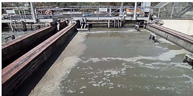
Figure 5 : Déshuilage et dessablage.
