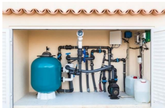
Photo 83: locale technique d'un jacuzzi
