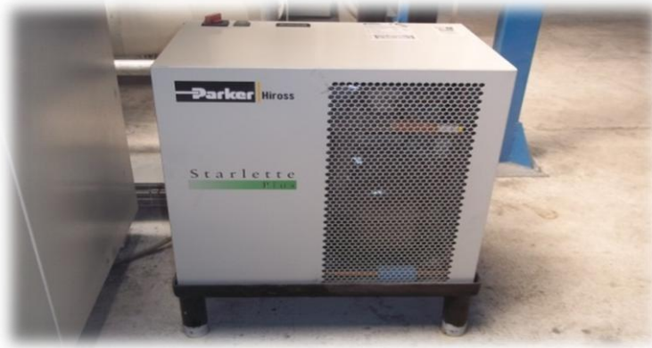
Figure I.11: Groupe de traitement d'air.
