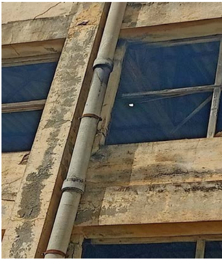
Figure VI.17b : Présence de moisissures et taches.
