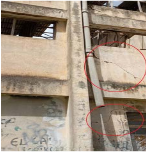
Figure VI.23a : Fissure oblique et sous forme d'escalier
