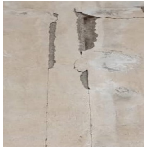
Figure VI.23b : Fissures verticales et horizontales
