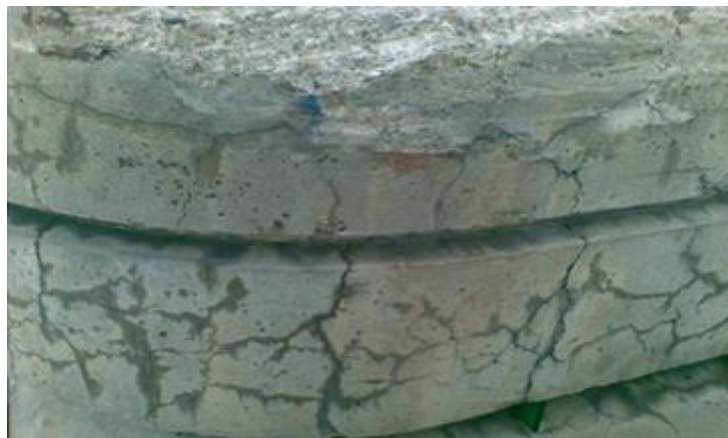
Figure I.9 : Fissures dues au gel / dégel [1]
