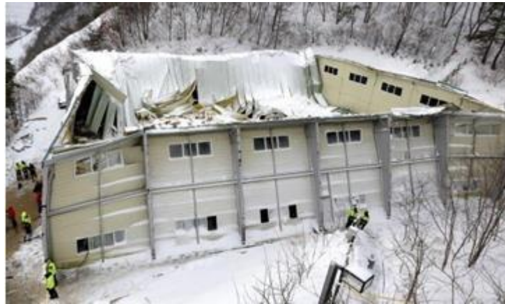
Figure I.19 : Effondrement d'un toit sous le poids de la neige [10]
