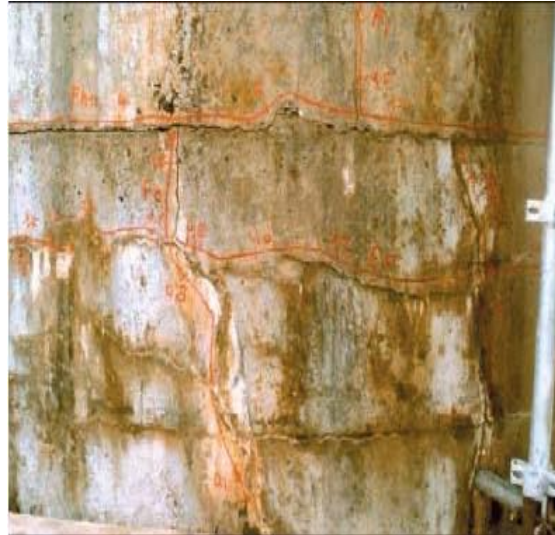
Figure I.10 : Pile de pont affectée par une réaction de gonflement [8]
