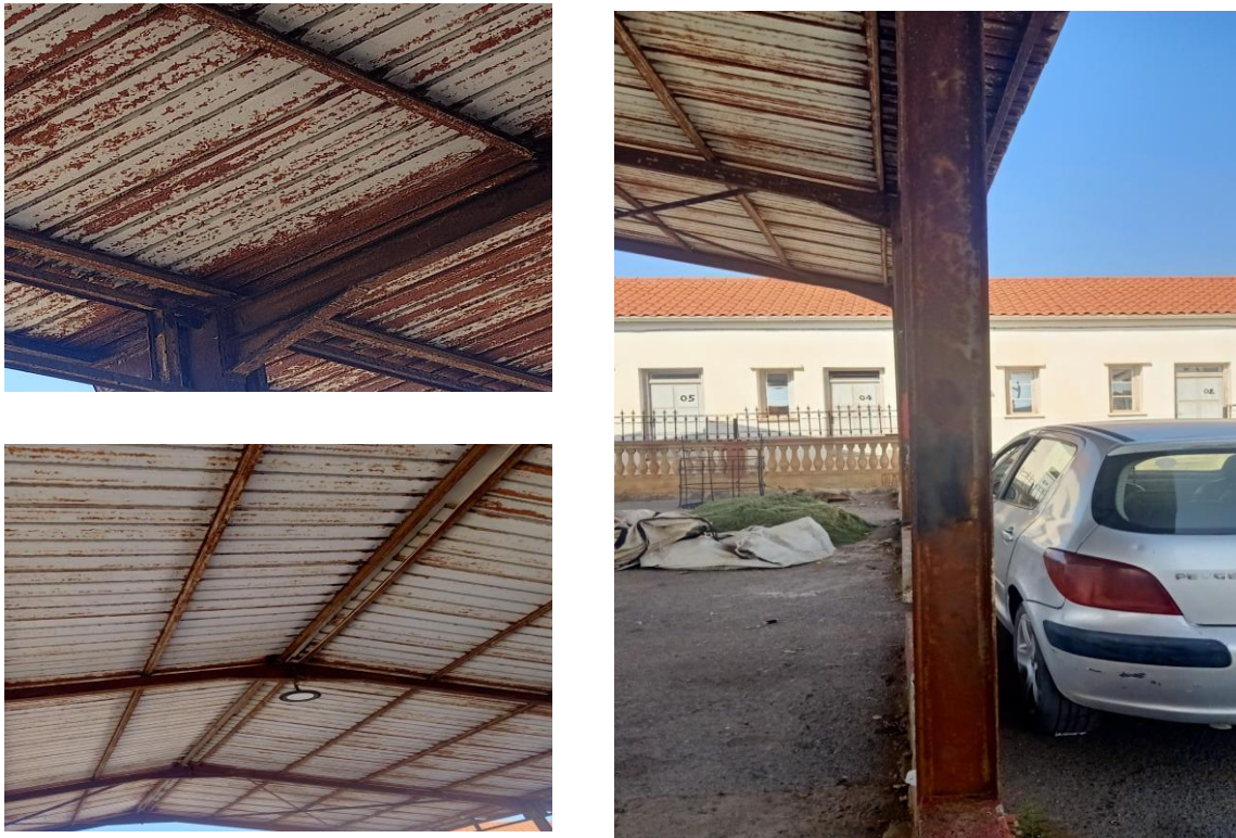
Figure I.1 : Corrosion d'un hangar métallique au port de Tizirt
