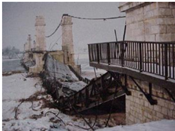
Figure I.3 : effondrement du pont de Sully-sur-Loire, France 1985 [8]
