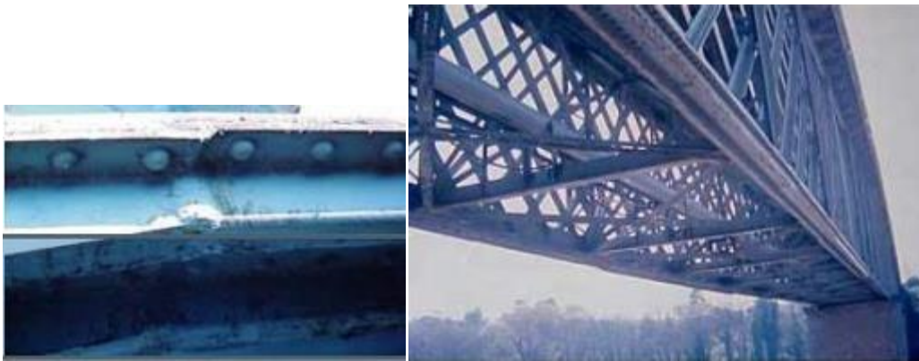
Figure IV.5 : Ajout de matière sous la membrure inférieure entre lignes de rivets (Pont de Douarnenez) [5]
