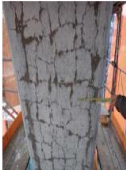
Figure I.11 : Fissures dues au phénomène de l'alkali-réaction [2]
