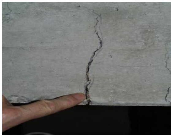
Figure I.8 : Fissures causées par le décoffrage prématuré [2]
