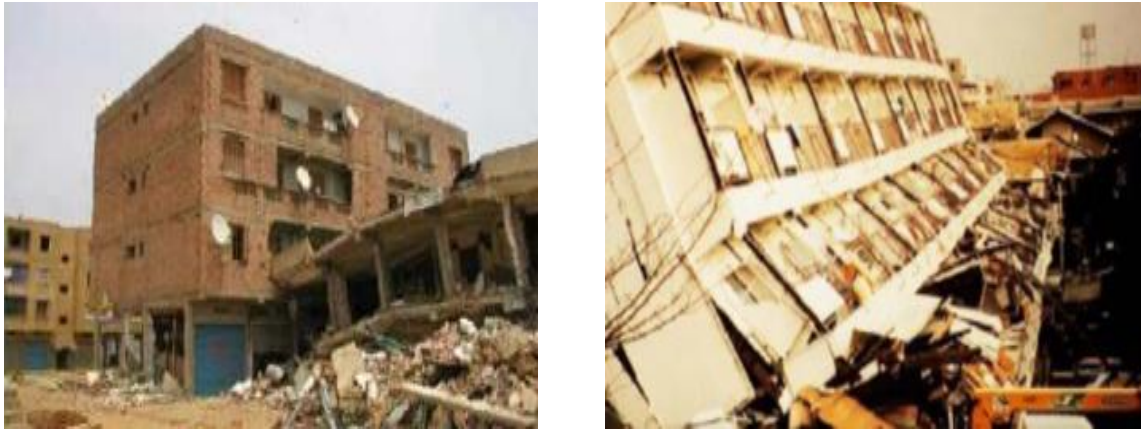
a) Effondrement d'une habitation [12]
