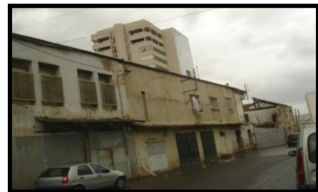
Figure 55: Hangars en mauvais état Source: Auteurs.
