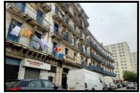
Figure 60: Effritement du béton de quelques habitations de type HBM Source: Auteurs.
