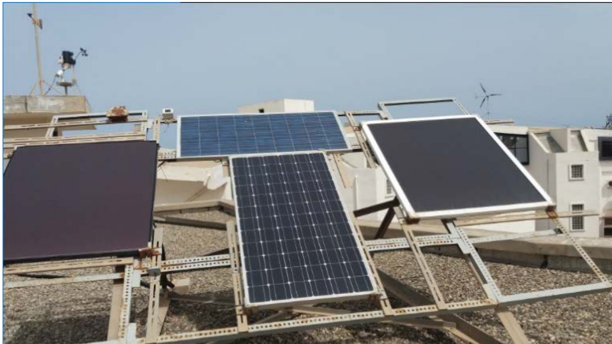
Figure III.10: Partie extérieure de la plateforme de caractérisation PV installée à l'UDES contenant les modules PV et les différents capteurs (Eclairage et Température).
