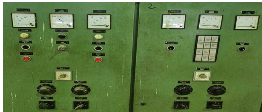
figure II 6: Les appareils installés sur le panneau frontal de l'armoire électrique
