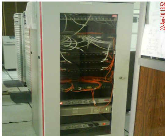
Fig. I.4 L'armoire d'étage centrale
