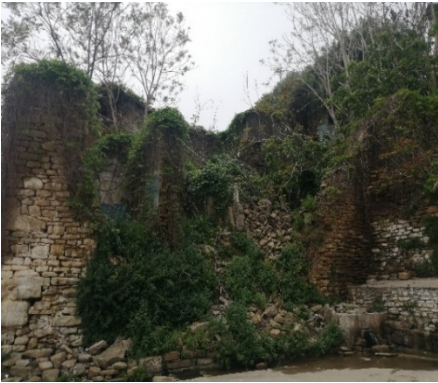
Figure68: bâtis en états de dégradation très avancé source : auteure
