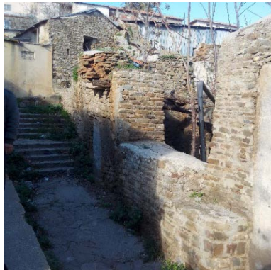
Figure69: bâtis en états de dégradation très avancé source : auteure
