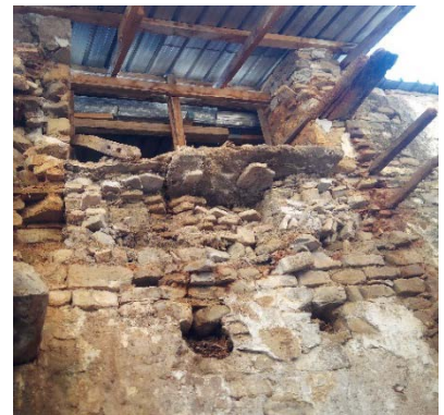
Figure70: bâtis en états de dégradation très avancé source : auteure
