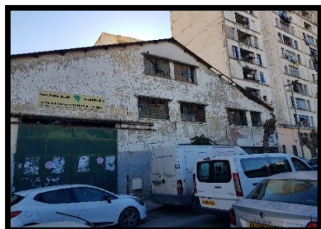
Figure 52 : Bâti mauvais état.
