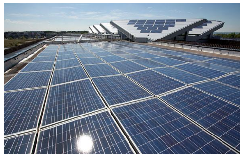
Figure132 :Les panneaux photovoltaïques Source : Pv élément structurant de l'architecture d'aujourd'hui pdf
