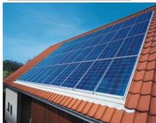
Figure232 : Panneaux photovoltaïques Source : http://www.solaire-guide.fr
