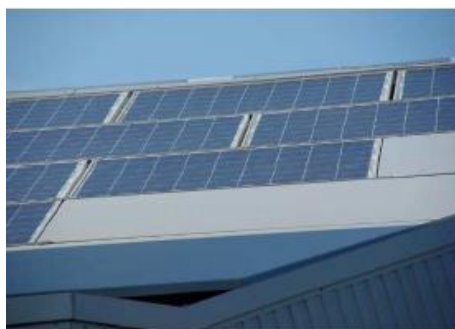
Figure131 : Les panneaux photovoltaïques Source :Pv élément structurant de l'architecture d'aujourd'hui pdf
