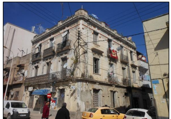
Figure 6 : bâti colonial dégradé Source : www.tsa-algerie.com/
