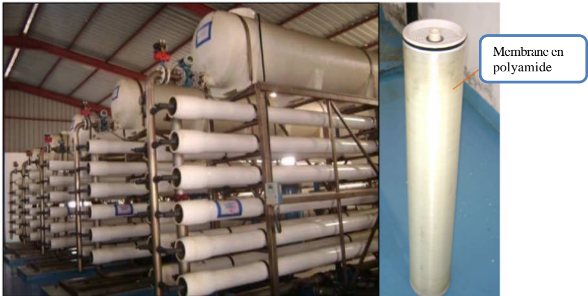
Figure I.4 : Système de membranes d'osmose inverse
