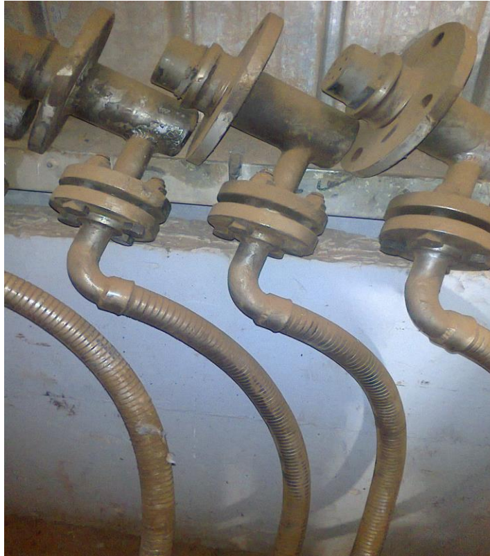
Fig.15: Injecteurs de combustible (photo prise sur le site par moi-même)
