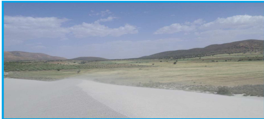
Figure 57 : Photo montrant le déplacement des éléments de la digue par l'effet du vent.
