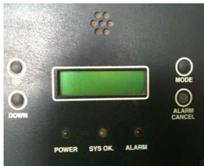
Figure III.5 : Système de surveillance du fonctionnement du VDR.
