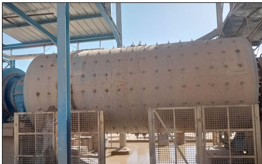
Figure III.3. Broyeur à boulets.
