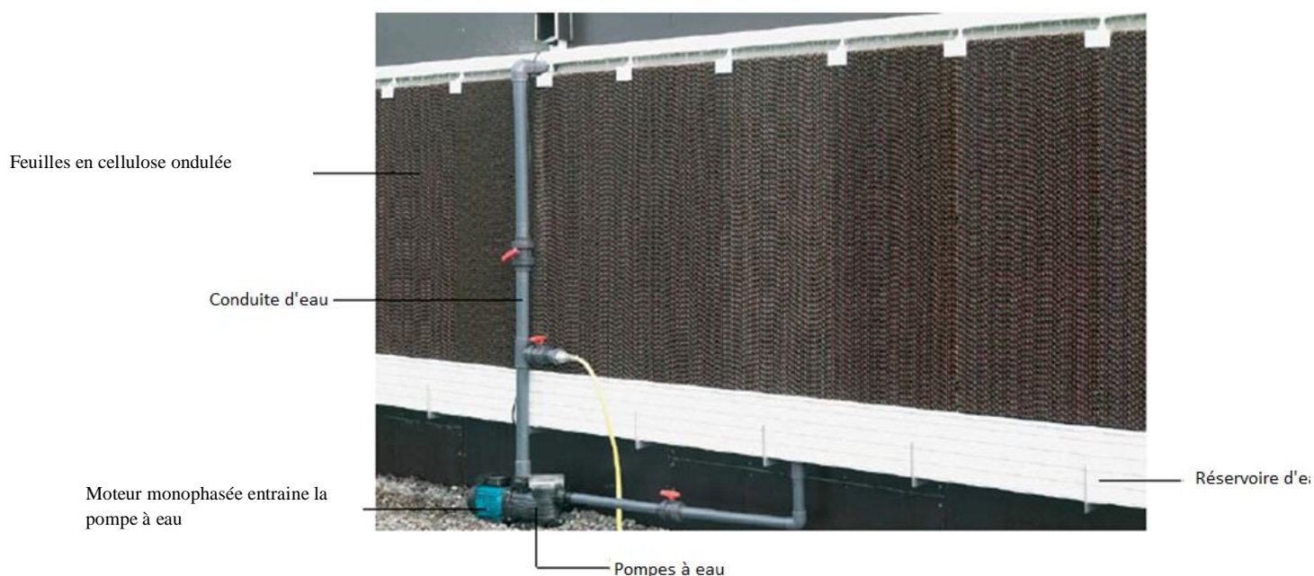
Figure 8 : Système de pompage de l'eau dans les pad cooling [13].
