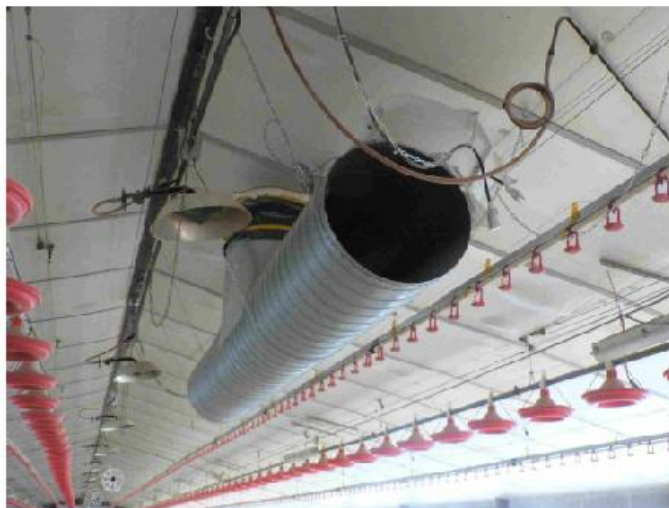
Figure 3 : Ventilateur d'évacuation des gaz
