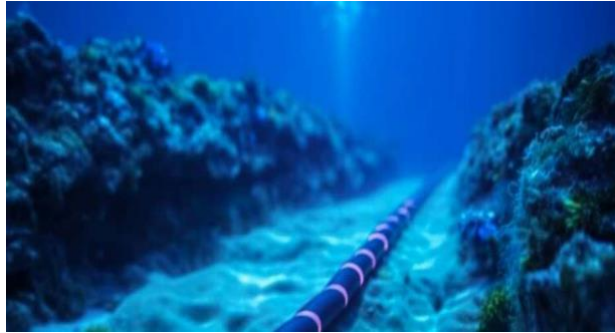
Figure I.17 : fibre optique pour un réseau sous-marin
