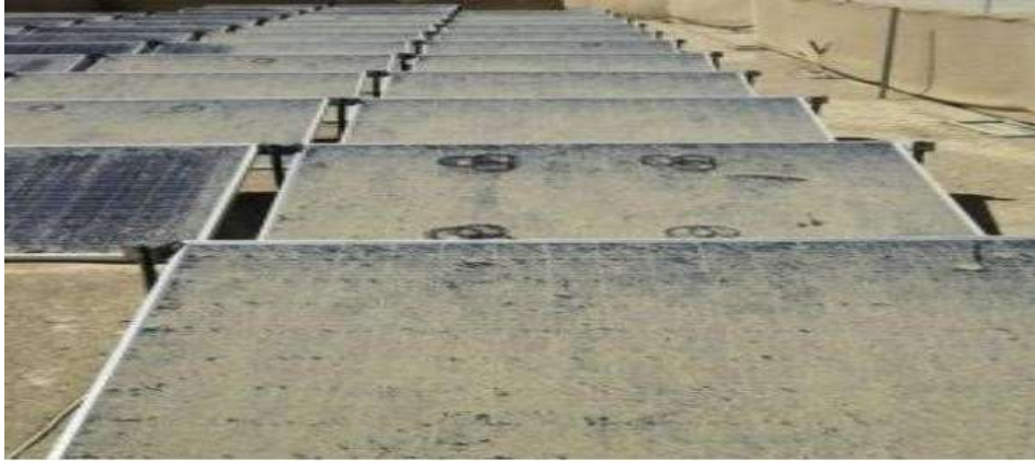
Figure II.5 : Photo de panneaux photovoltaïques endommagés par un vent de sable [55].
