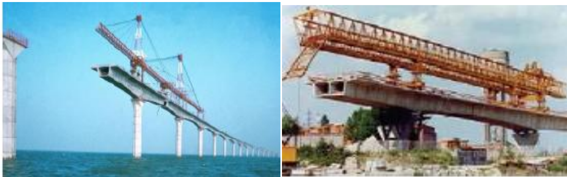
Fig. II.7 Construction du viaduc de l'Ile de Ré à l'aide d'une poutre de lancement.
