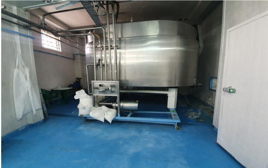
Photo originelle de la cuve d'égouttage.
