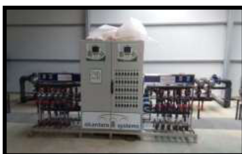
Figure 22 : Photo d'une armoire électrique de contrôle et de commande
