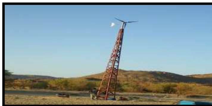
Figure 18 : Image représentative d'une éolienne pour le pompage de l'eau
