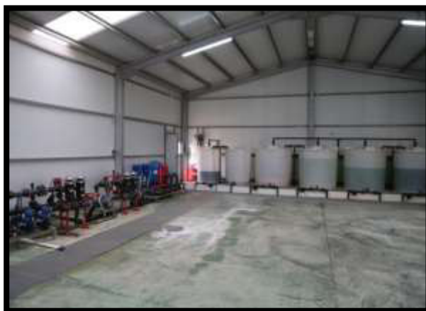
Figure23 : Photo représentative de bloc de déminéralisation
