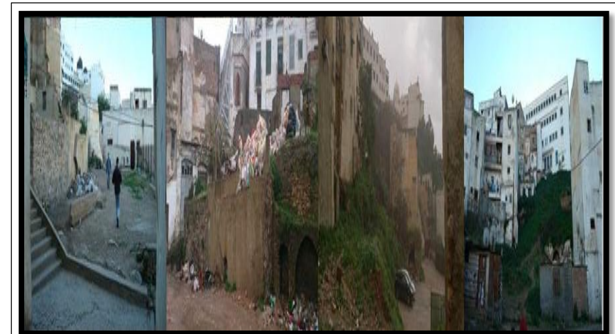
Figure 30: L'état dégradé de la casbah Source : photo prise par l'auteur
