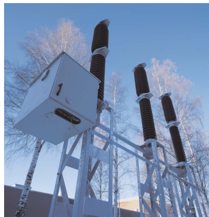
Fig (II-4) : Disjoncteurs à SF6
