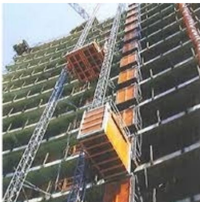
Figure3.11 : Ascenseurs des chantiers [1]
