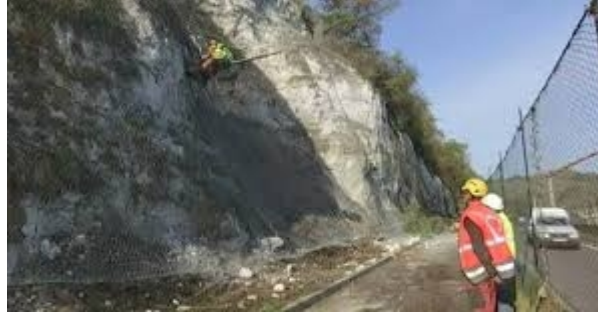
Figure 8 : Eboulement des parois rocheuses[1]
