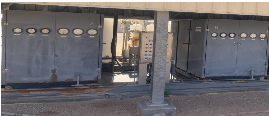
Figure II.1 : Les compresseurs d'air.
