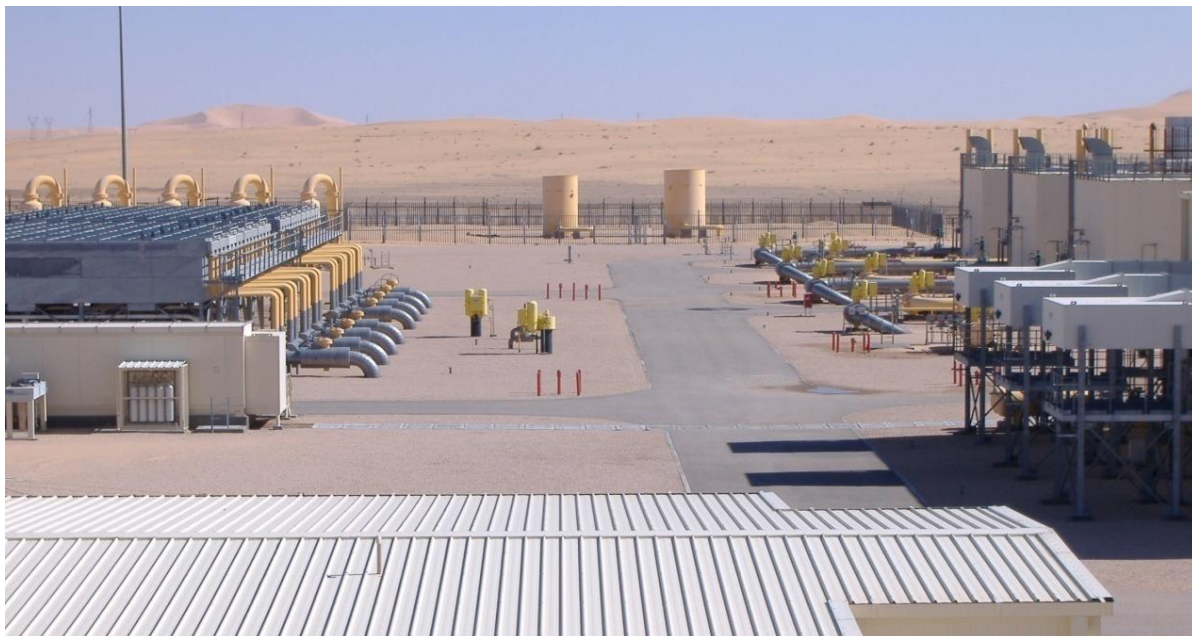
Figure I.5 : Vue d'ensemble de station Zina.
