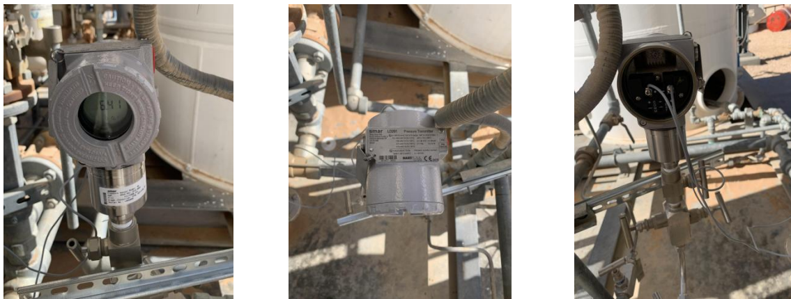
Figure II.13 : Transmetteur de pression PIT.
