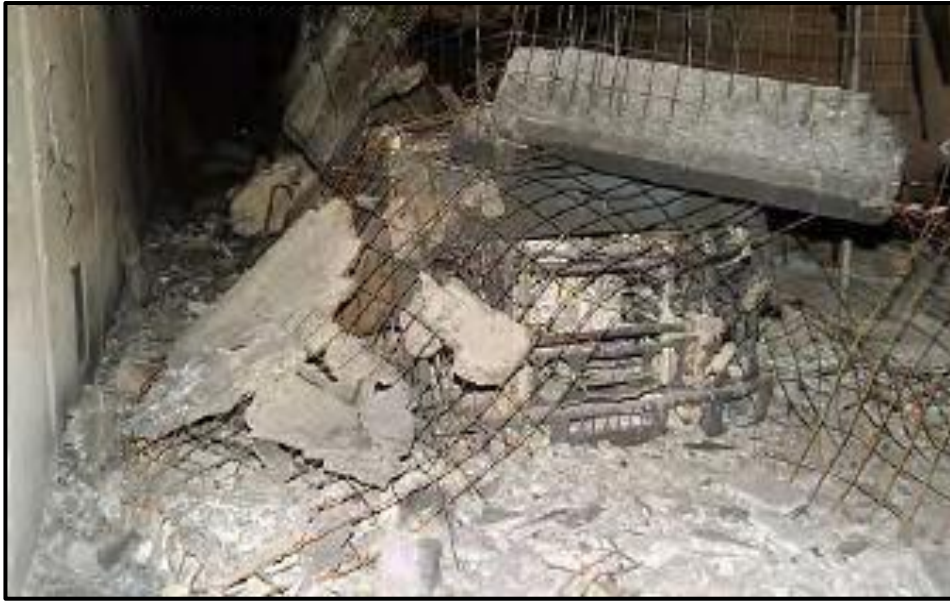
Figure II.4 : Section effondrée du faux plafond dans le tunnel du Gothard après l'incendie du 21 octobre, 2001 thèse doctorat 2007 Anaba.
