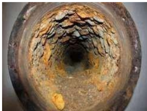
Figure I.8 Corrosion par érosion
